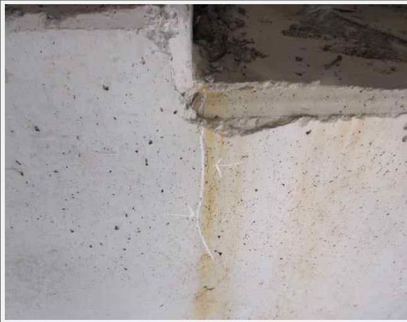
배골교(상주) 균열 (0.3mm미만) P1 코핑부
