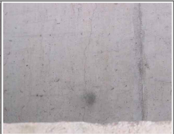
배골교(영천) 균열(0.3mm 이상) A2
