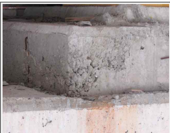
배골교(영천) 받침콘크리트 재료분리 P2
