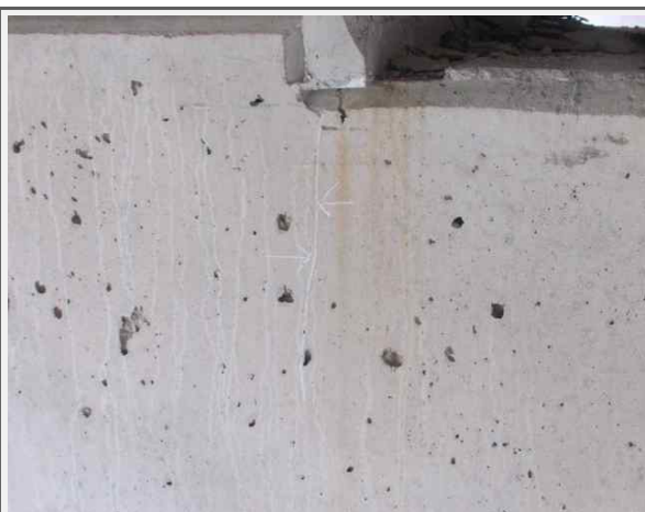
배골교(영천) 균열 (0.3mm미만) P2 코핑부
