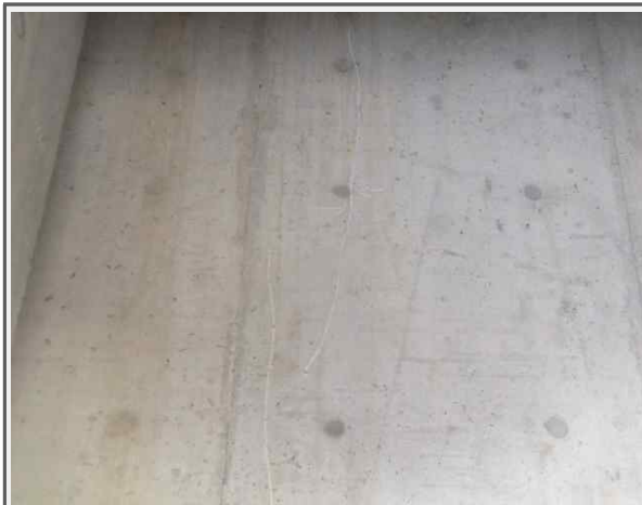
배골교(상주) 균열(0.3mm 이상) A2
