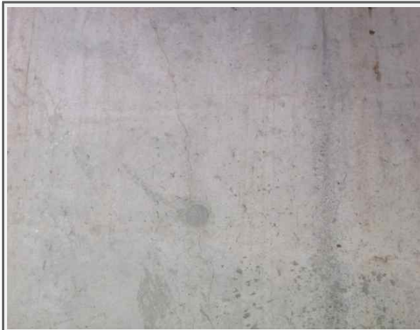
배골교(영천) 균열(0.3mm 미만) A2
