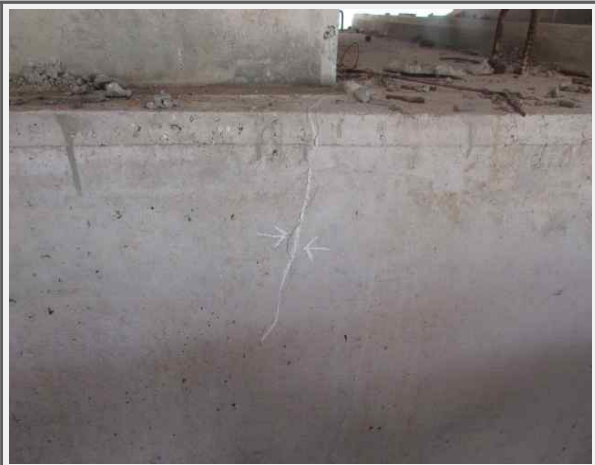
배골교(영천) 균열 (0.3mm이상) P1 코핑부
