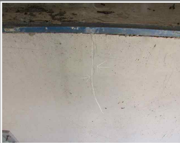
배골교(상주) 균열 (0.3mm이상) P2 코핑부
