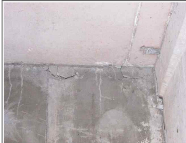
배골교(영천) 파손, S3 가로보
