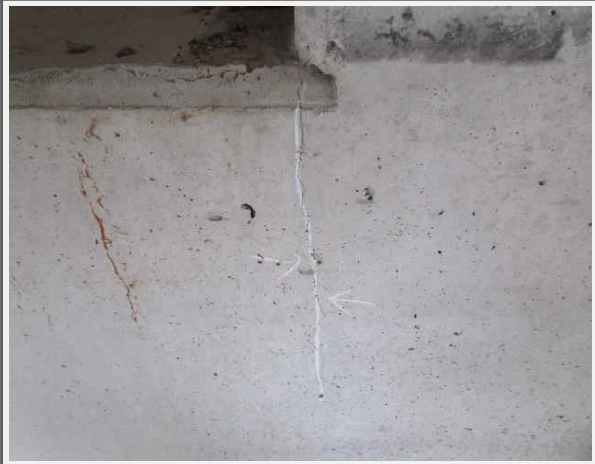
배골교(상주) 균열 (0.3mm이상) P1 코핑부
