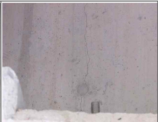
배골교(영천) 균열(0.3mm 이상) A1
